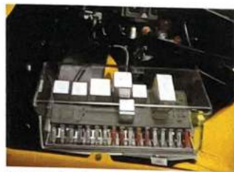
Die Zentral-Elektrik ermöglicht schnellen Austausch von Sicherungen, Relais, transistorisierten Schaltkreisen.
