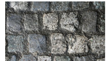
4 Sobre un firme irregular.
