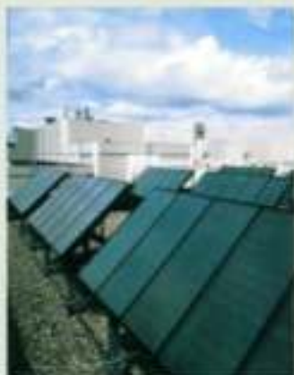
Het dak van de fabriek is bedekt met 200 m 2 zonnecellen, die zorgen voor verwarming van de douche- en wasruimten.
